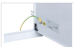
Cable de conexión a toma de tierra
